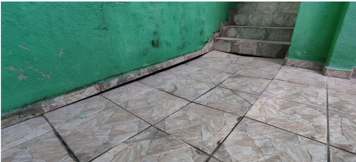
FOTO 12 : Área descoberta. Afundamento parcial do piso.
