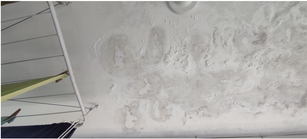
FOTO 42 : Sobrado 02 - superior: detalhe de manchas de infiltração e umidade no teto da área de serviço.
