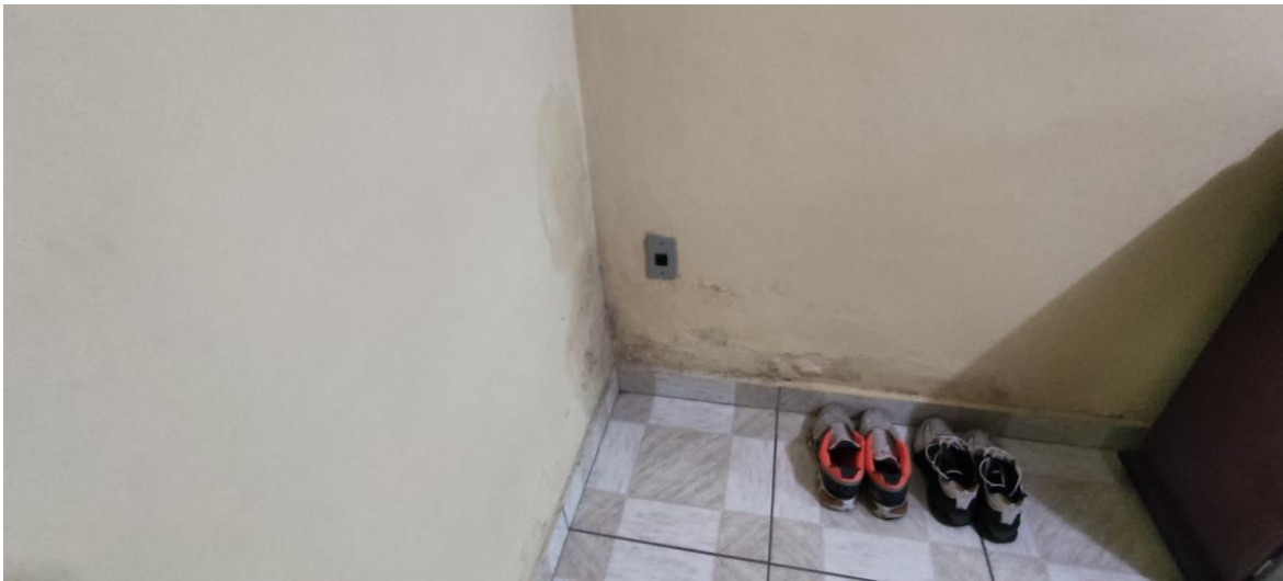
FOTO 17 : Sobrado 01 - térreo: sala, mancha de umidade.
