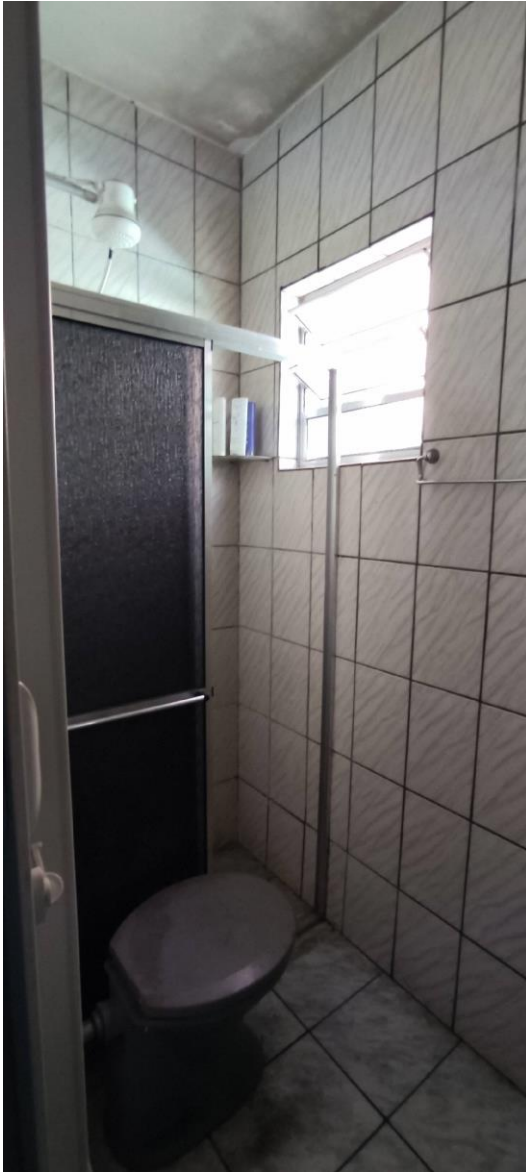
FOTO 26 : Sobrado 01 - superior: wc da suíte 2. Mancha de umidade no teto
