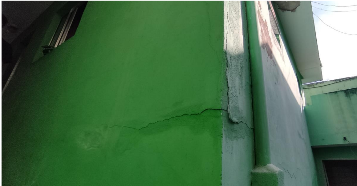
FOTO 14 : rachadura na parede do porão e sobrado 2 - térreo.
