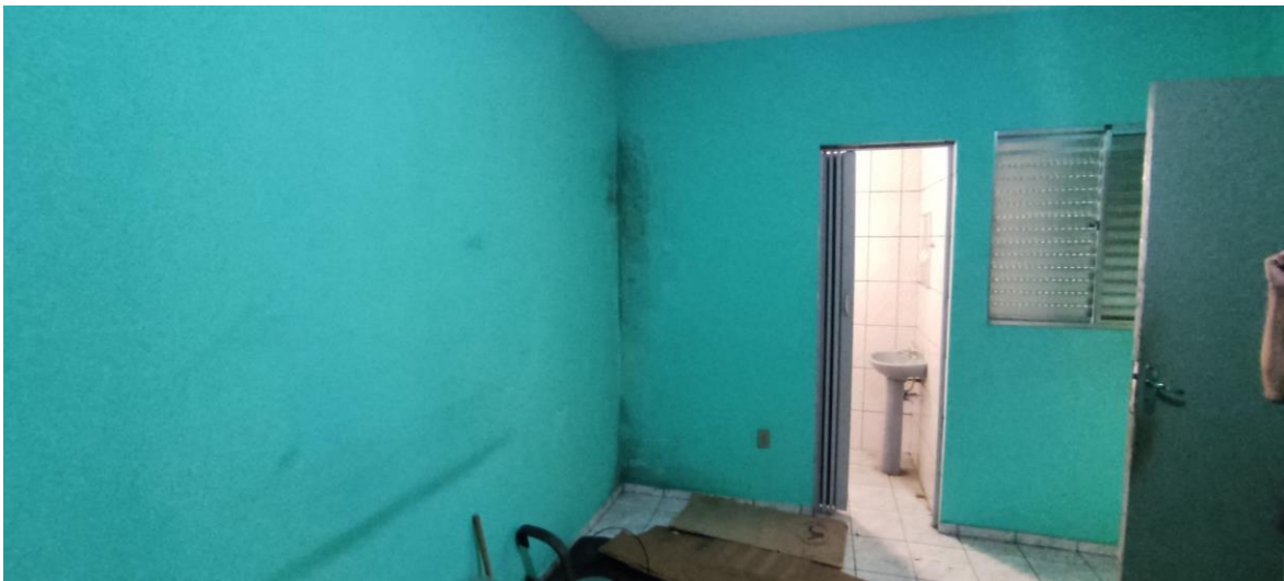
FOTO 25 : Sobrado 01 - superior: suíte 2, mancha de umidade no canto da parede.
