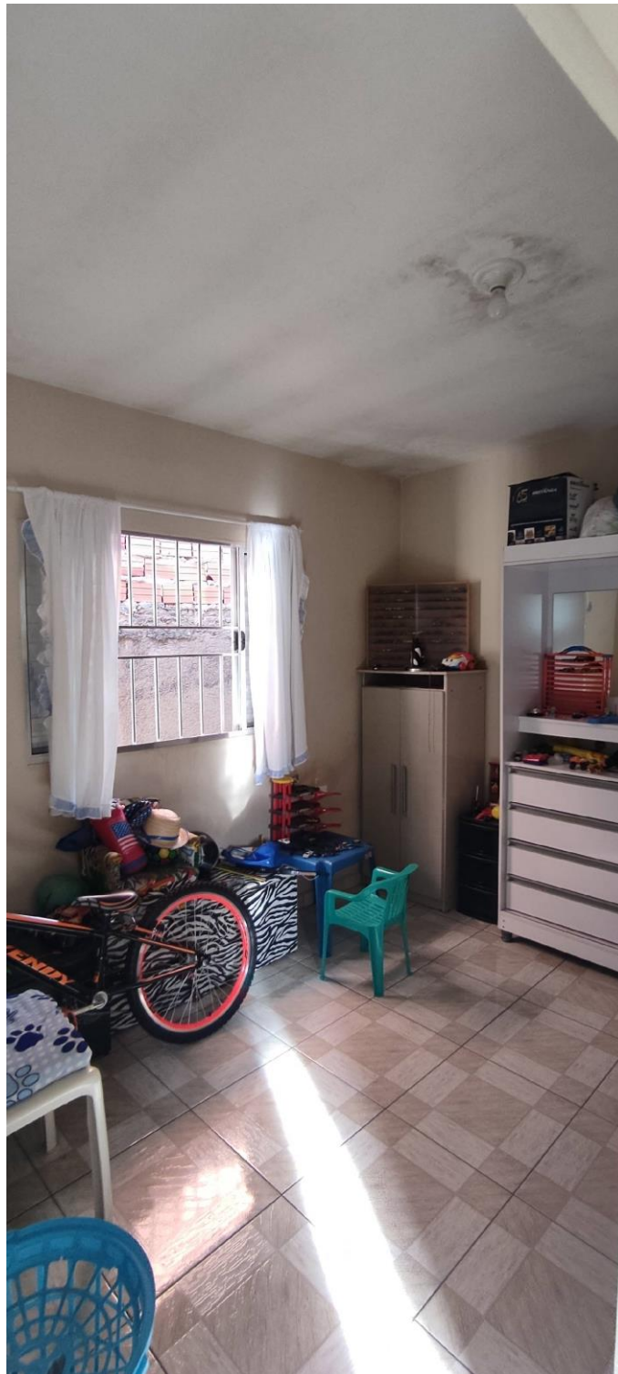
FOTO 44: Sobrado 02 - superior: vista parcial do dormitório 2. Mancha de umidade no teto.
