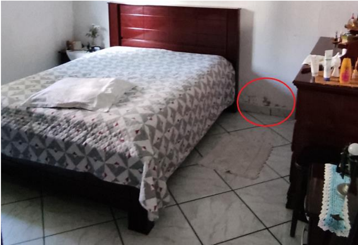
FOTO 33 : Sobrado 02 - térreo: dormitório, mancha de umidade na parede.
