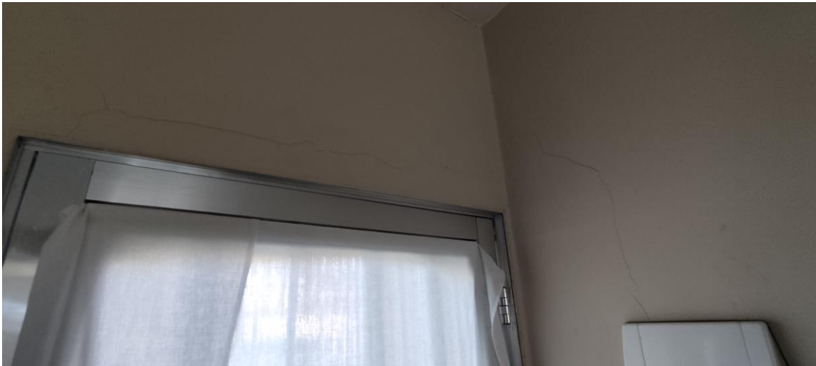
FOTO 47 : Sobrado 02 - superior: detalhe de fissura na parede da sala.
