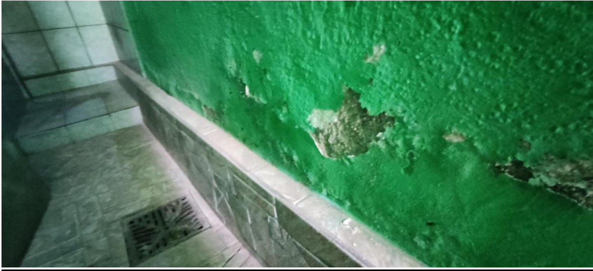
FOTO 13 : corredor lateral externo do sobrado 01: patologia na pintura.
