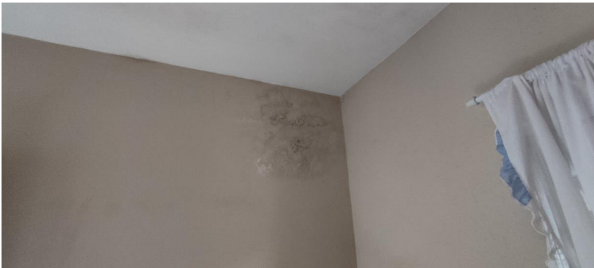
FOTO 43 : Sobrado 02 - superior: detalhe de manchas de infiltração e umidade na parede do dormitório 2.
